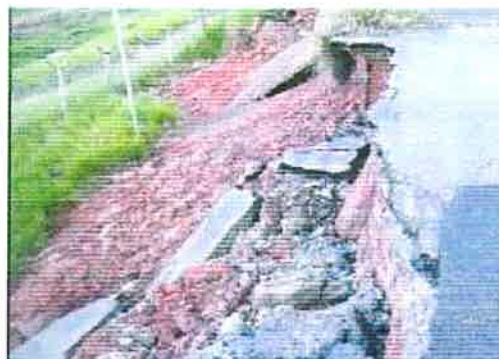
DETALHE DO DESCOLAMENTO
