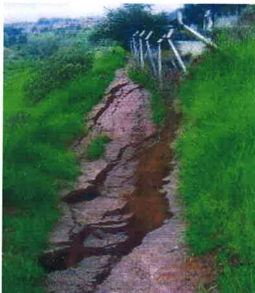
DETALHE DO DESCOLAMENTO
