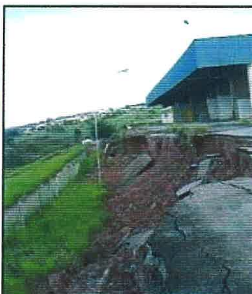
DETALHE DO DESCOLAMENTO
